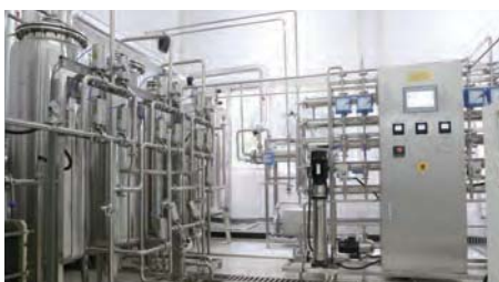
大型中央水处理系统
